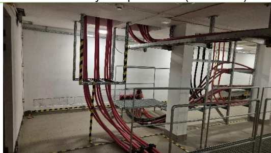
40. GPZ Gorzyce – poziom -1 (kablownia)
