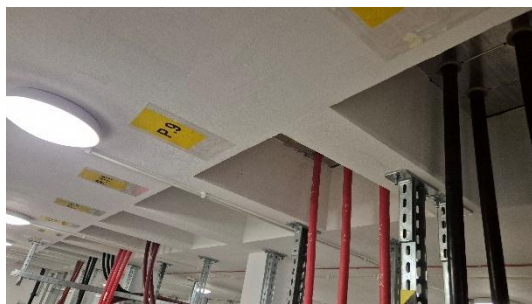
32. GPZ Gorzyce – poziom -1 (kablownia)
