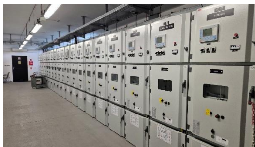
44. GPZ Gorzyce – poziom 0, pomieszczenie rozdzielni SN, pola przyłączeniowe Inwestycji
