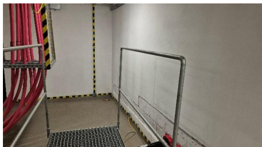
27. GPZ Gorzyce – poziom -1 (kablownia), przepusty kablowe
