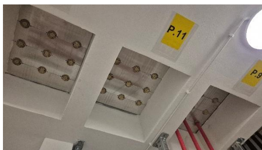
36. GPZ Gorzyce – poziom -1 (kablownia)
