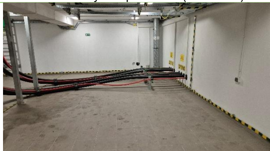
39. GPZ Gorzyce – poziom -1 (kablownia)
