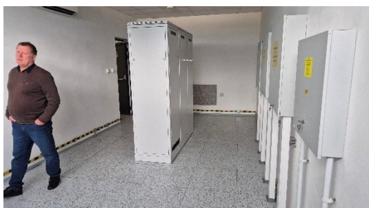
45. GPZ Gorzyce – poziom +1, pomieszczenie teletechniki – miejsce przyłączenia światłowodu Inwestycji
