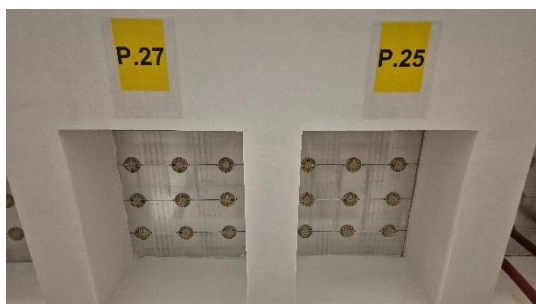
35. GPZ Gorzyce – poziom -1 (kablownia)
