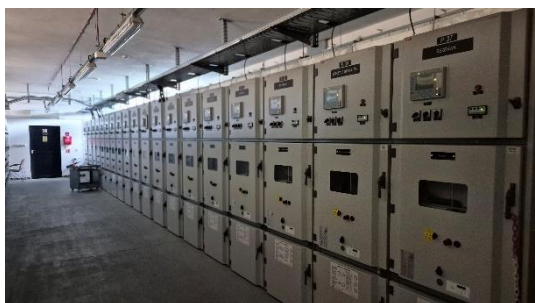
43. GPZ Gorzyce – poziom 0, pomieszczenie rozdzielni SN, pola przyłączeniowe Inwestycji
