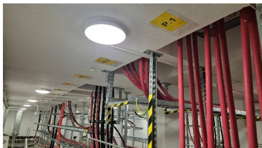
31. GPZ Gorzyce – poziom -1 (kablownia)
