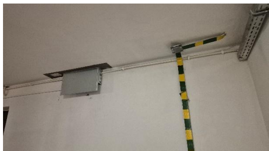
29. GPZ Gorzyce – poziom -1 (kablownia)
