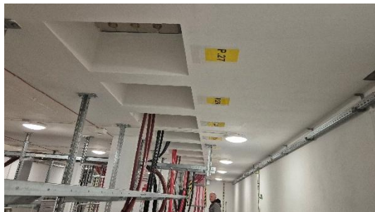
34. GPZ Gorzyce – poziom -1 (kablownia)
