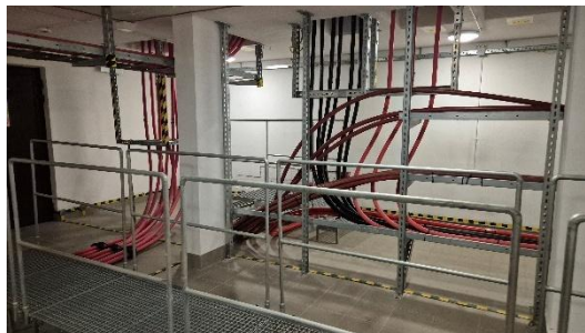
42. GPZ Gorzyce – poziom -1 (kablownia)
